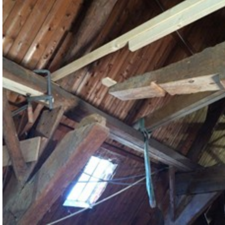
Afbeelding 4: Deel van het spant is verwijderd. Te zien zijn het spantbeen met pen, de korbeel met blinde pen en de schuine lip aan de hanenbalk. Foto: Stadsherstel Amsterdam.
