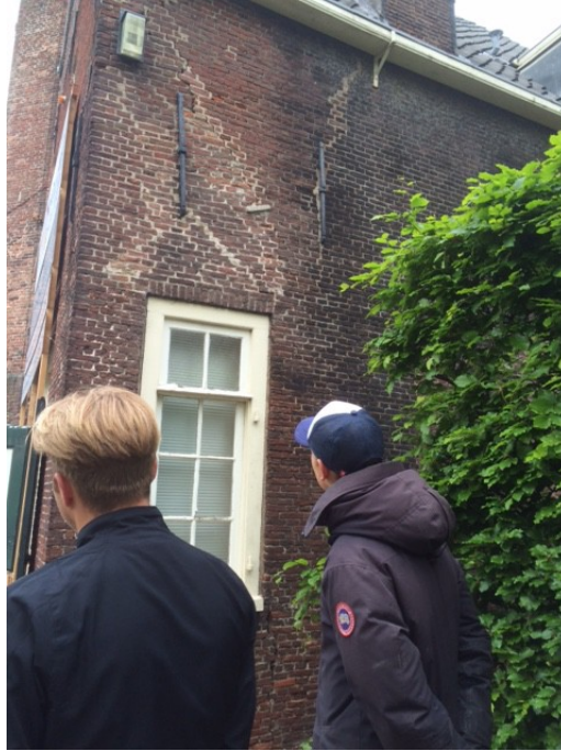
Afbeelding 6: vochtproblemen in de buitenmuur ontstaan door verzakkingen
